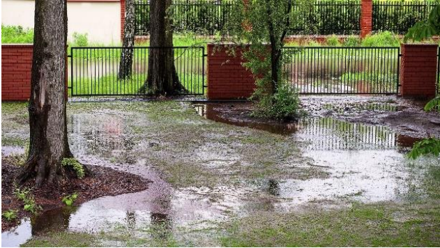
Mal drenaje de zona ajardinada
